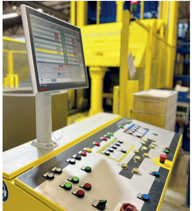
Panel kontrolny zapewnia wygodną obsługę.
