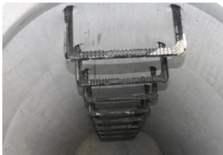
Szczeble włazowe wbijane są w dyble umieszczone w ścianie wyrobu.
