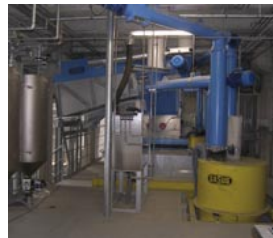
Pyłoszczelny system transportu kruszywa; wagi wody, zawiesziny i cementu.
