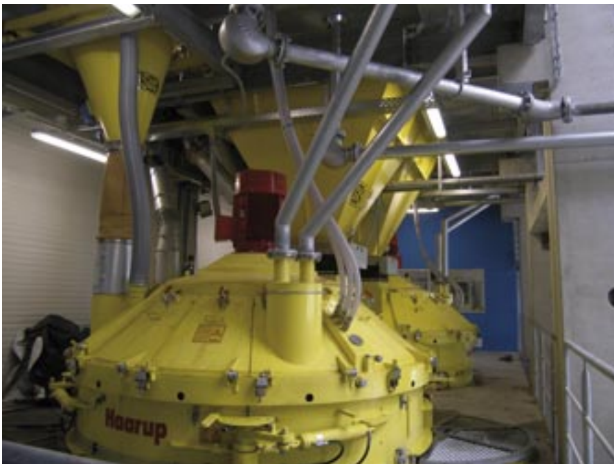
Mieszarka planetarna firmy Haarrup typu 3000, pośredni zbiornik na kruszywo i waga cementu.
