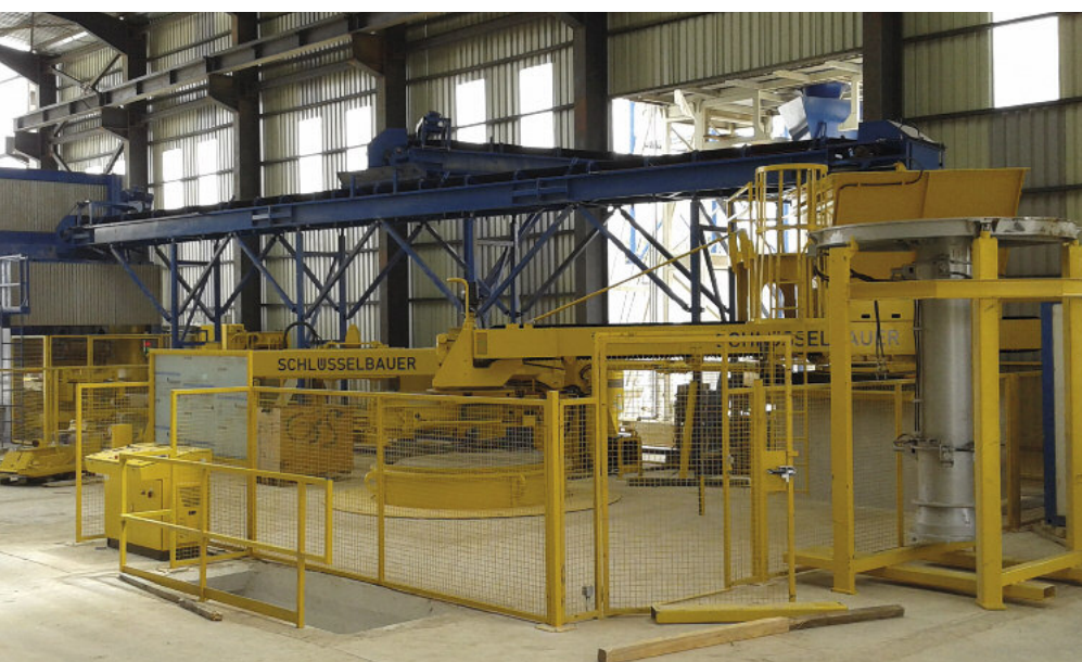
Automatyczny system produkcyjny Exact XL do rur betonowych w zakładzie firmy Trans-Canal Centre w Algierze.
