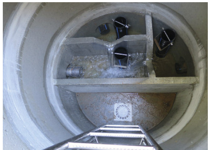
Wnętrze zbiornika DN1500 wykonanego na miarę przez Wyss AG. Zbiornik posiada wiele wlotów oraz 4 komory i zastosowany jest w systemie pozyskiwania wody w gminie Vitznau w rejonie Jeziora Czterech Kantonów.
