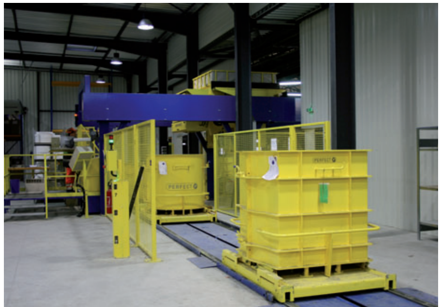
Los moldes preparados entran de forma automática en la estación de hormigonado
