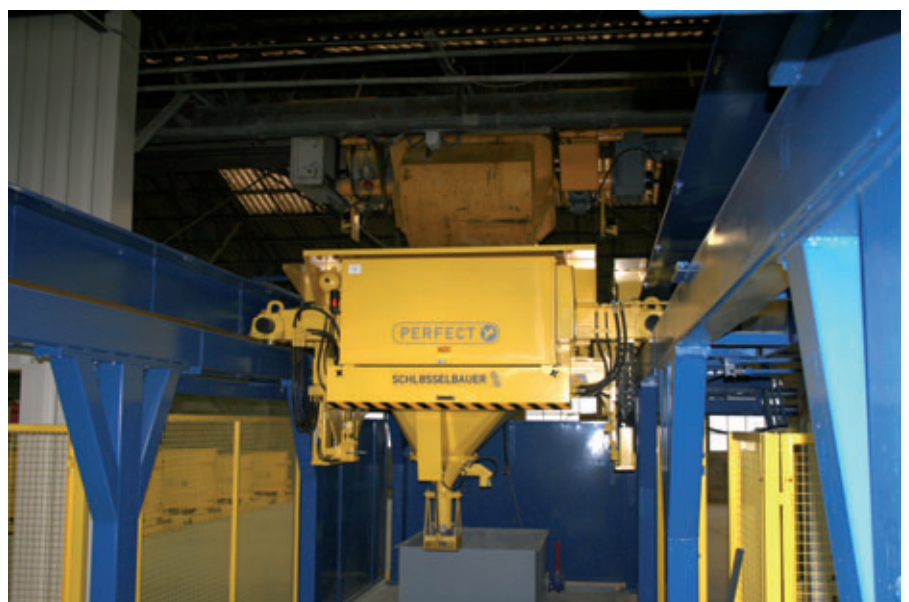
La vía de cubetas de la nave contigua abastece también a la producción Perfect con HAC
