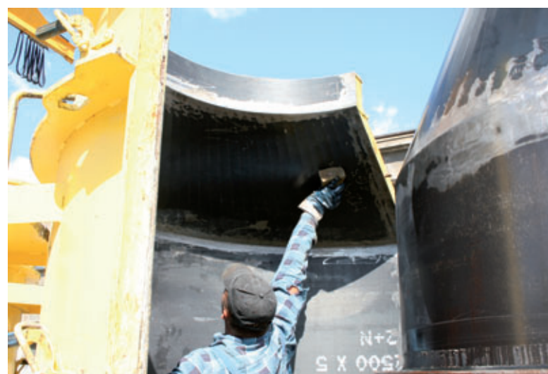
Lubricación de las superficies del pozo con agente desencoformador, Ortolan SEP 791 de MC Bauchemie
