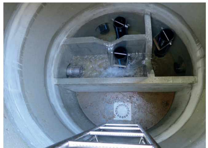
Vista al interior de una arqueta de hormigón a medida fabricada por Wyss AG, de DN1500 y con varias salidas y cuatro cámaras en el lugar de captación de fuente del municipio de Vitznau am Vierwaldstättersee.
