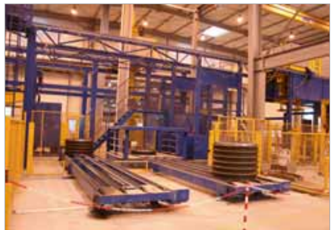
Die Anlage verfügt über ein vollautomatisches Muffenhandlingsystem.
