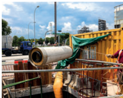
Die Vorteile von Betonrohren – hohe statische Belastbarkeit und Robustheit für den Baustellenalltag – wurden mit einer Rohrwandstärke von 130 mm nochmals verstärkt.
