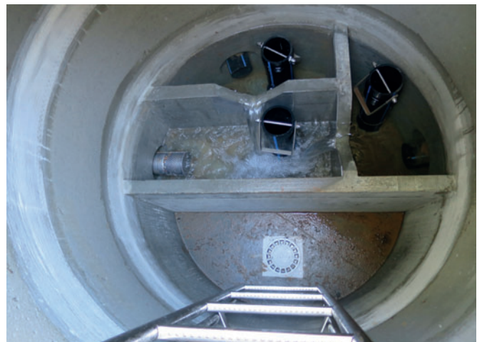
Blick ins Innere einer von der Wyss AG maßgefertigten Betonbrunnenstube DN1500 mit mehreren Zuläufen und 4 Kammern am Quellfassungsstandort der Gemeinde Vitznau am Vierwaldstättersee
